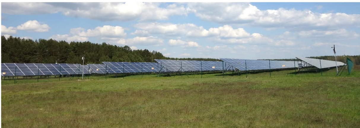
Widok na farmę fotowoltaiczną w Gryźlinach. (Foto: kol. Dariusz Stecki)
